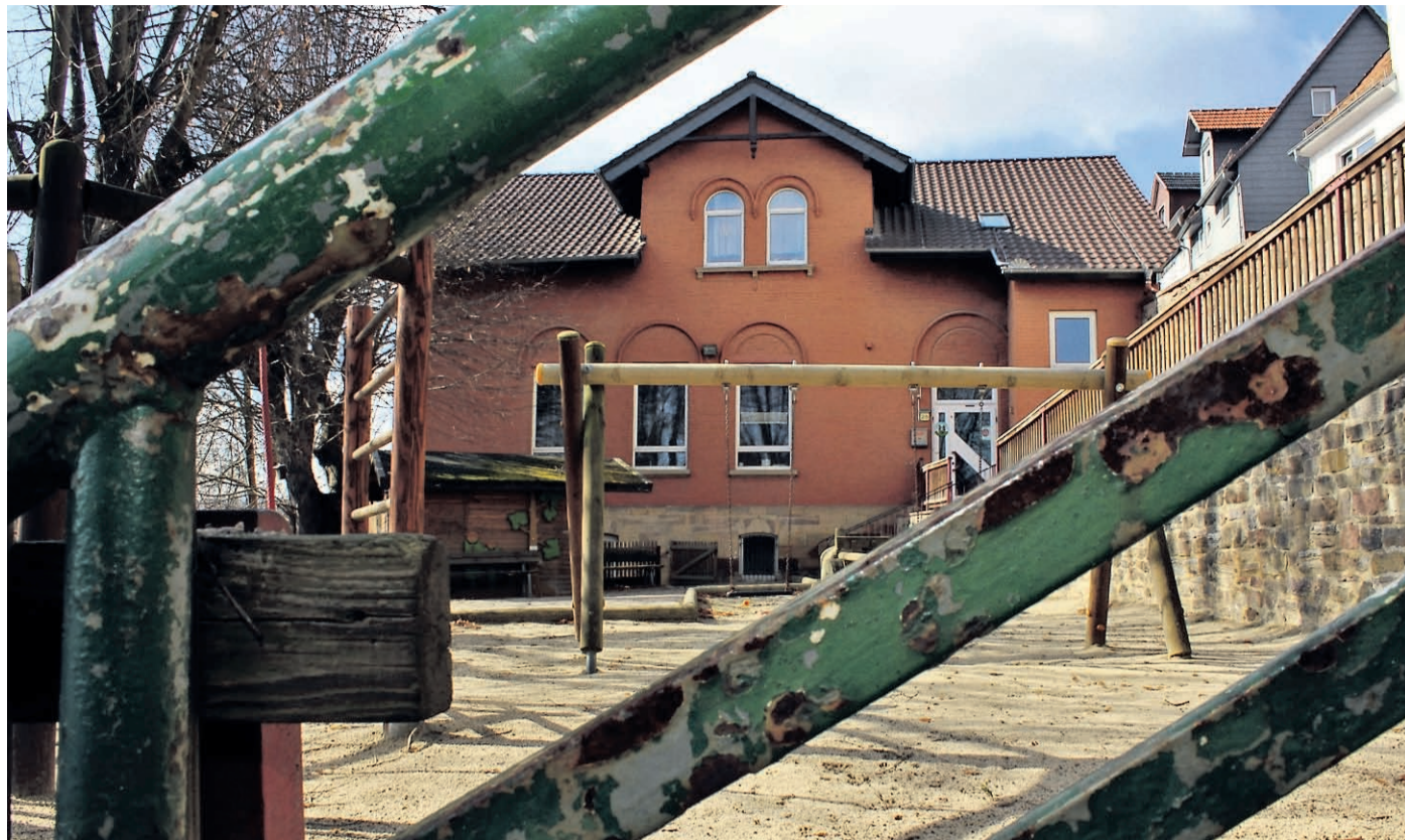
Vorige Woche waren die nachträglich entdeckten Schäden in der Decke von Webers Kindergarten öffentlich bekannt geworden. Ein Teil von ihnen ist bereits behoben. Aktuell verzögert sich das Sanierungsprojekt wegen des gefundenen Hausschwamms. Foto: Schuldt
