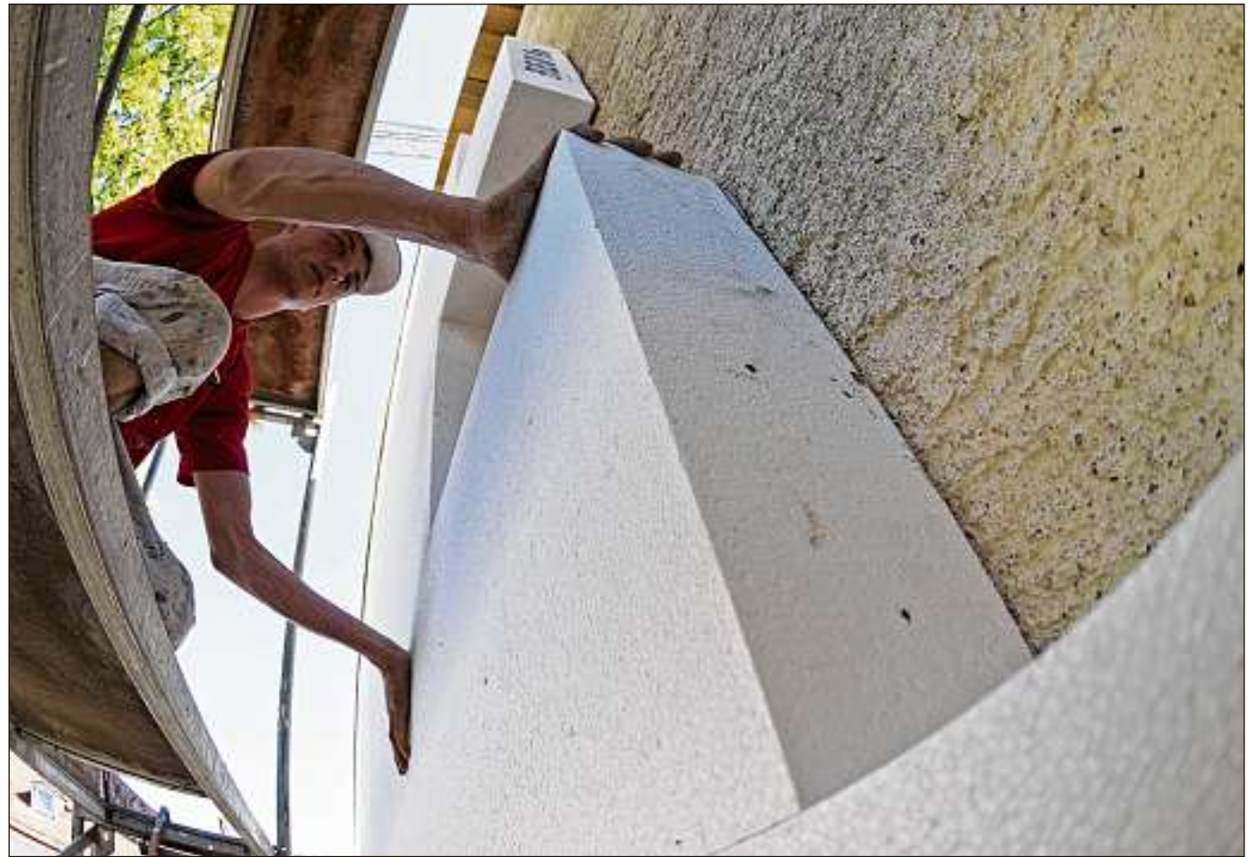
„Hauswende“: Auf Gebäude entfallen 40 Prozent des Energieverbrauchs. Sinkt der Anteil durch Styropor?
